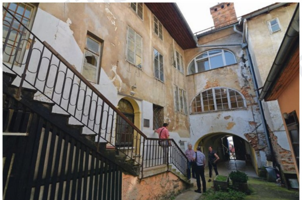
Hiša je desetletja kazala klavno podobo, treba jo je bilo tudi statično utrditi.
