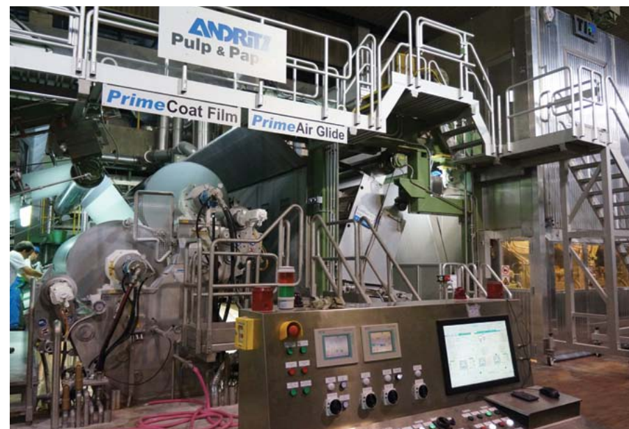
Vgrajena »filmpreša« Filmpress installed
