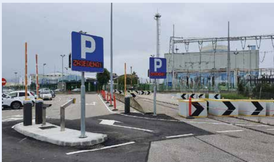
Prikaz strojne opreme sistema prepoznave registrskih tablic
