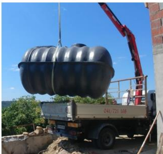
Biološka čistilna naprava
