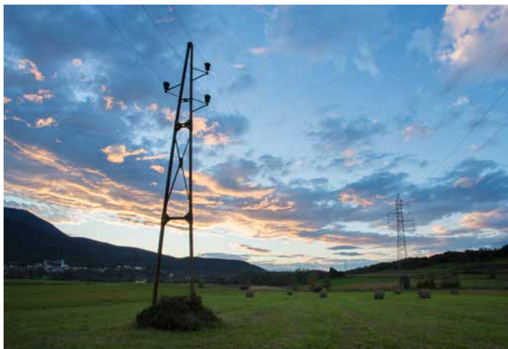
Elektro Primorska je v načrtih ohranil investicije iz naslova ojačitev za potrebe vključevanja OVE v omrežje v nespremenjenih vrednostih.
