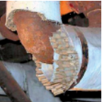
Poškodovana cevna izolacija
