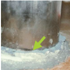
Cementno vezani žlebovi
